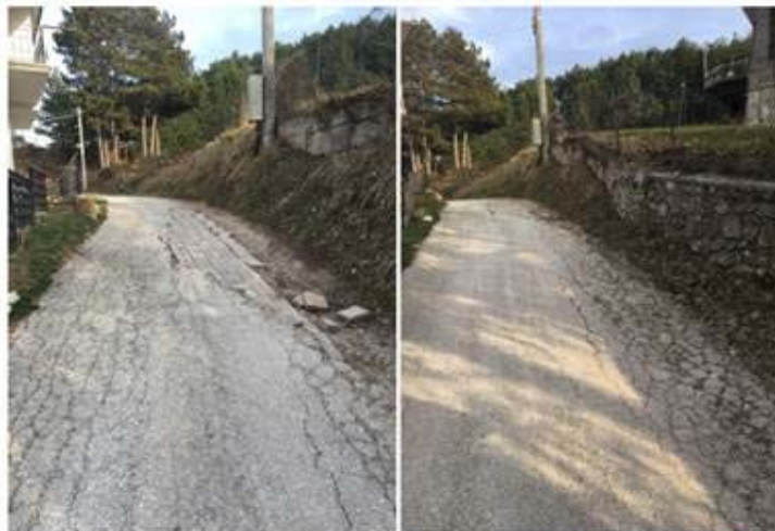
Слика 2 Сегашна состојба на улицата „Питу Гули“ која е предмет на реконструкција
